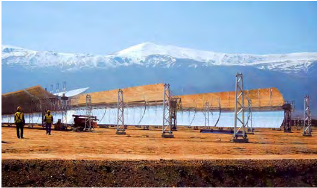
Foto: Andasol Kollektoren. Quelle: Flagsol GmbH
